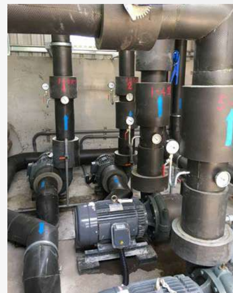
水循環管線包覆保溫材料
