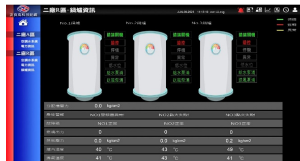
圖 2. 鍋爐資訊監控系統
