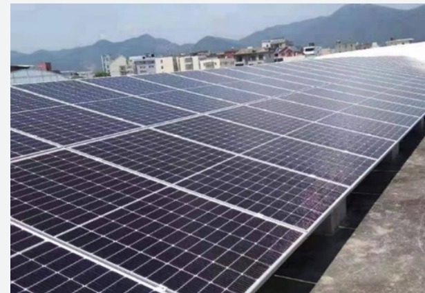
圖 3. 同良使用太陽能為生產設施提供電力。
